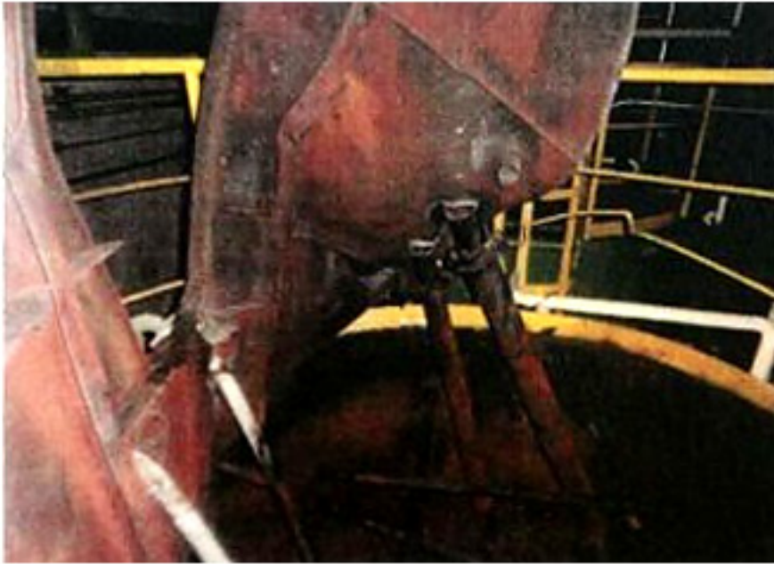
รูปหลังจากการเกิดเหตุ : ฝ้าด้านบนของ TA-2 tank
