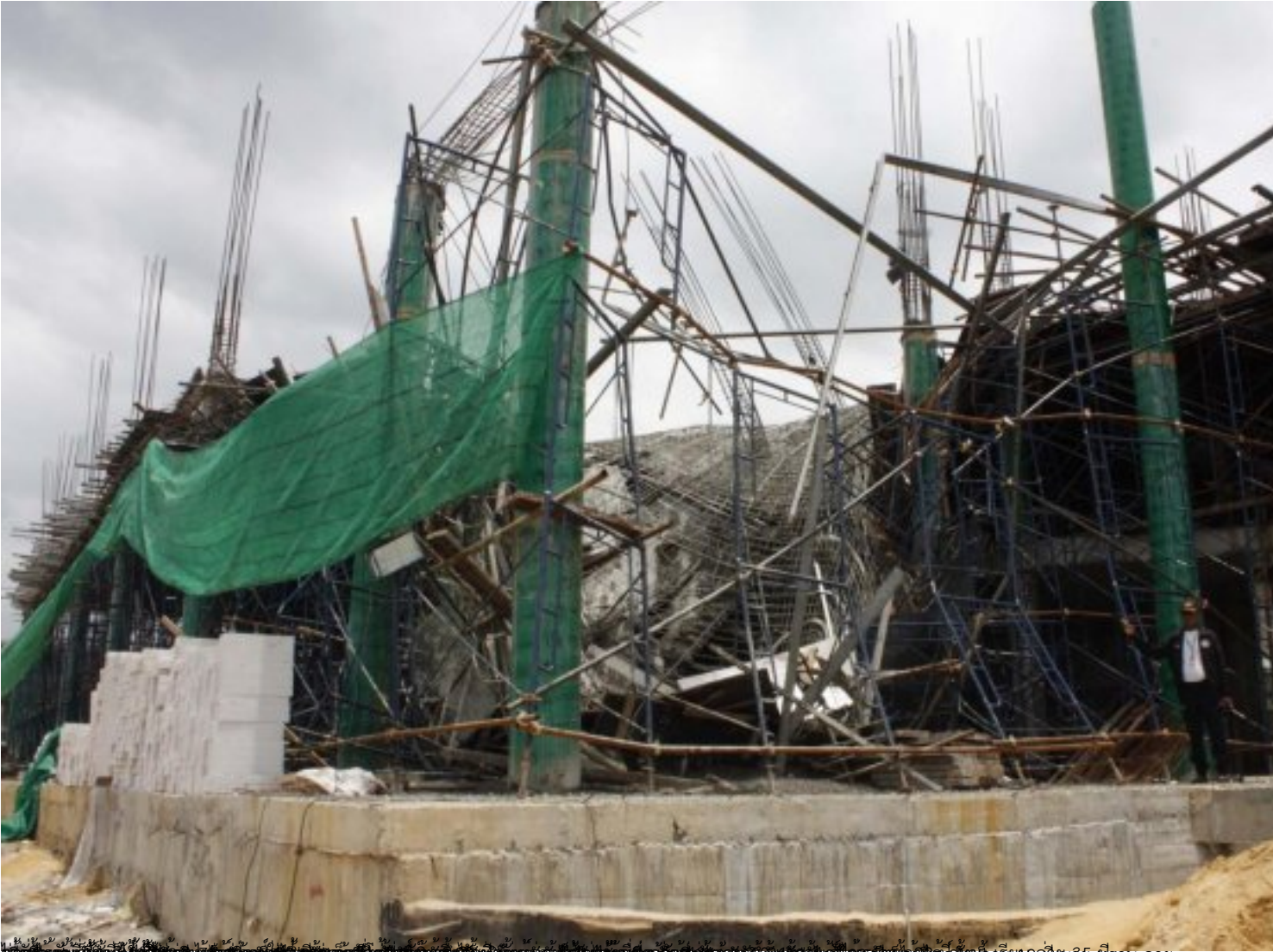
ผู้สื่อข่าวรายงานว่า ผู้ปฏิบัติงานที่ก่อสร้างโหลวมรดกลมทับคนงานเจ็บ 12 ราย ที่มา : เดลินิวส์
